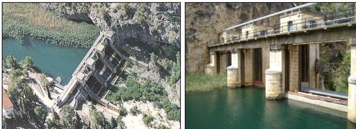
Figura 3. Imágenes del avance de vegetación junto al paramento aguas arriba.
