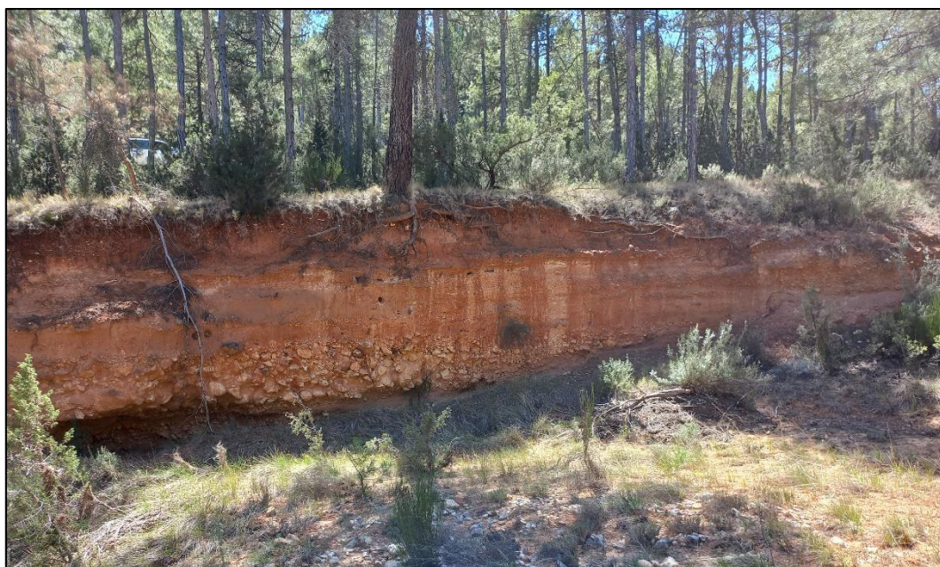
Ilustración 124. Procesos erosivos sobre una de las márgenes del barranco en el entorno de los diques 1, 2 y 3
