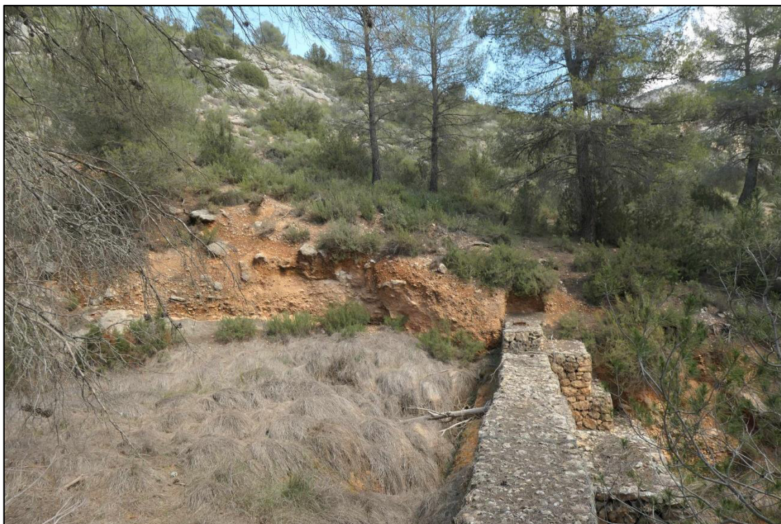
Ilustración 37. Detalle dique 3 (colmatado)
