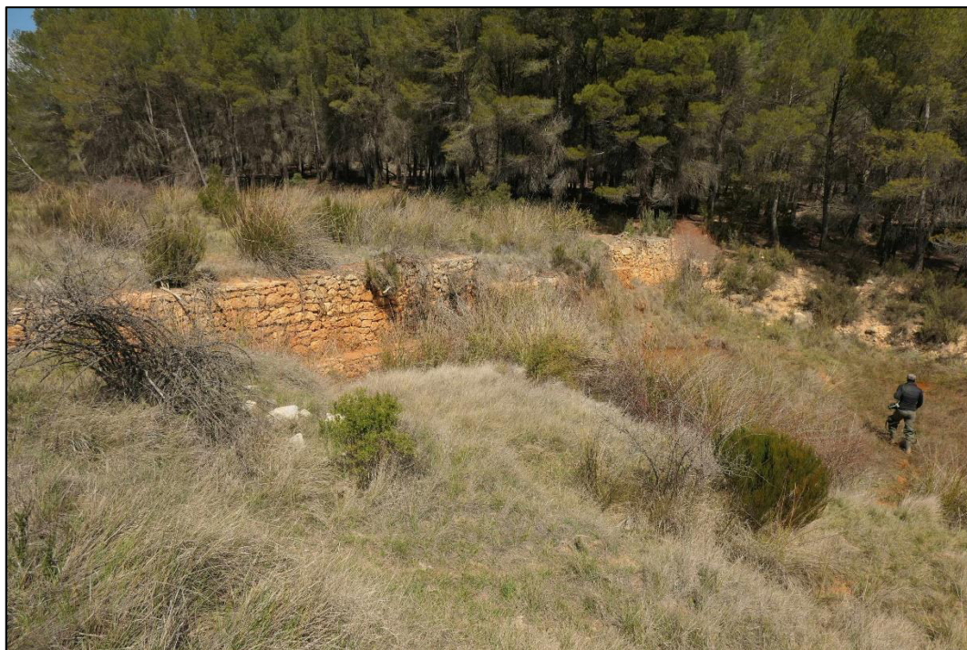
Ilustración 38. Detalle dique 4 (colmatado)
