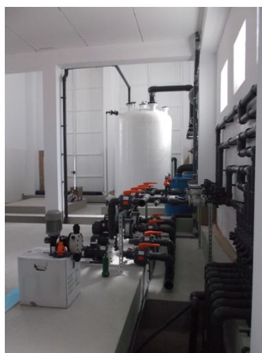
Instalaciones de dosificación
