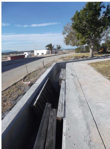
Canalización para dosificación
