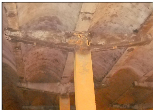
Crucetas antes de las obras.
