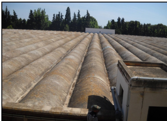
Estado del exterior de la cubierta antes de las obras.
