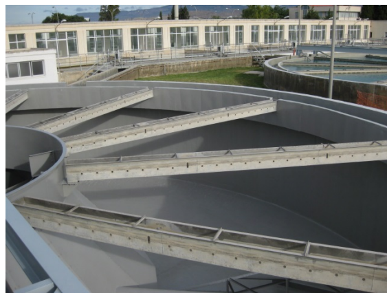
Estado final decantador
