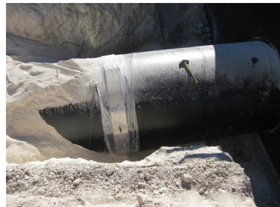
Tubo conexión arqueta canal salida.
