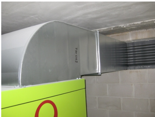
Nuevo grupo electrógeno.
