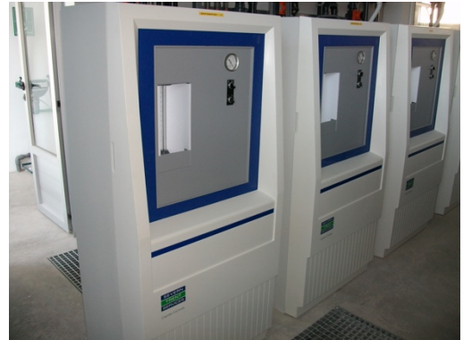
Nuevas cabinas de cloración.
