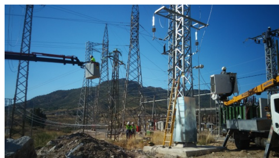
Entronque con la subestación.
