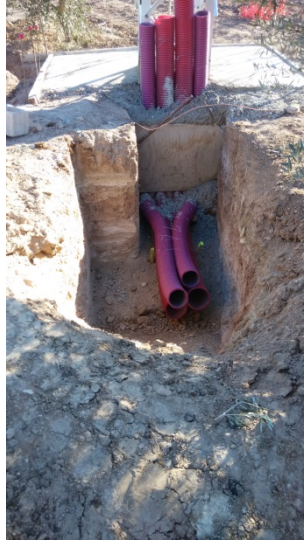
Entronque aéreo subterráneo.
