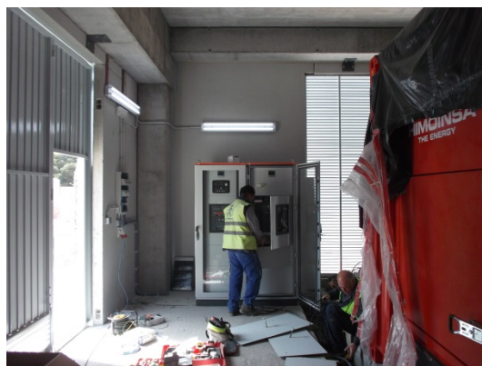
Cuadro control grupo electrógeno.
