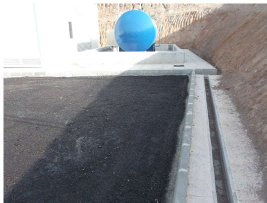
Nuevo depósito de gasoil.
