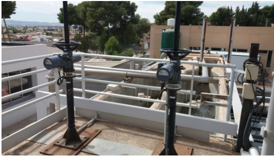
Actuadores obra llegada planta
