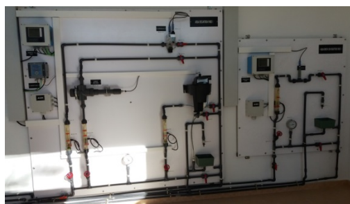
Panel analizador agua decantada fase 1
