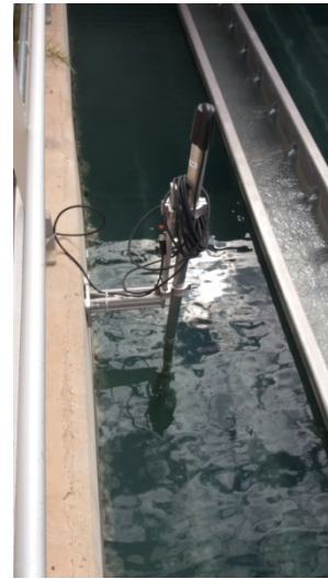
Medidor concentración sólidos decantadores
