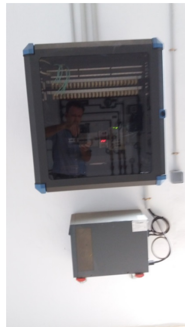
Fibra óptica planta
