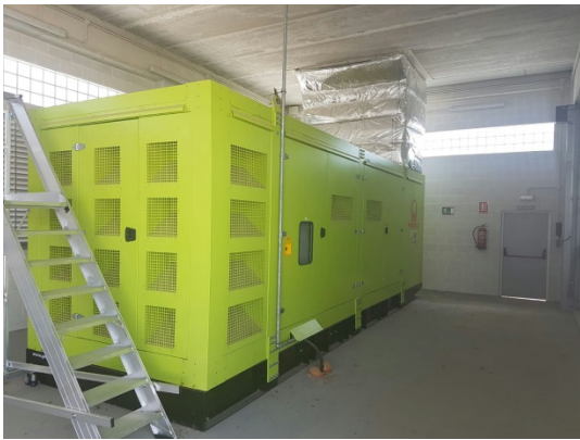
Nuevo grupo electrógeno
