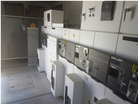
Nuevo centro de transformación
