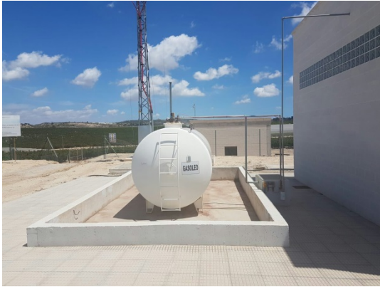
Nuevo depósito de gasoil
