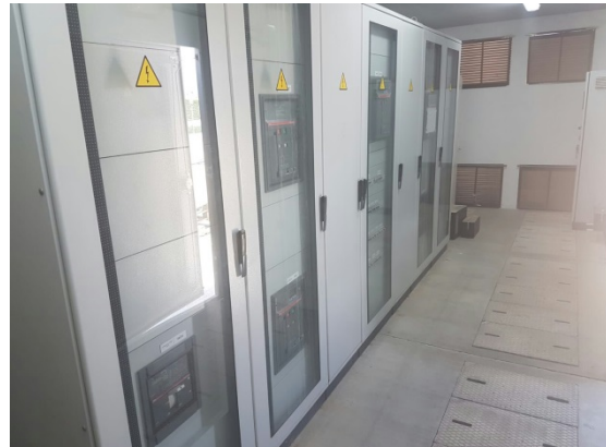
Nuevos cuadros de baja tensión
