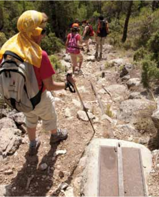
La Canaleta del Barranco del Gallego, muy deteriorada en la actualidad, permite practicar el montañismo por su trazado. MAG
